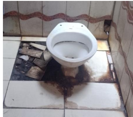
Photo 4 : Cuve de toilette inconfortable Source : Kaki 2024
