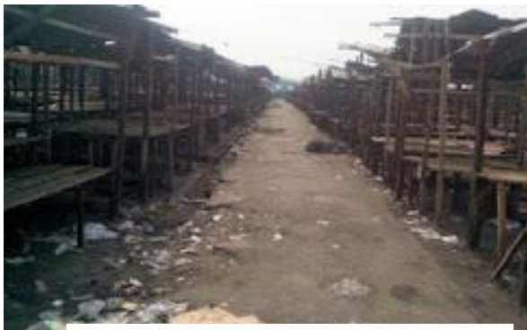
Photo 10 : Etals vieux et délabrés Source : Résultat de terrain 2024
